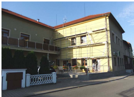
V letošním roce zbyly peníze pouze na část fasády...
