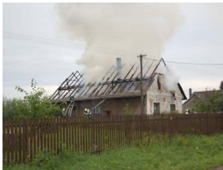
Rada požárů má příčinu v závadě na komínovém tělese.
